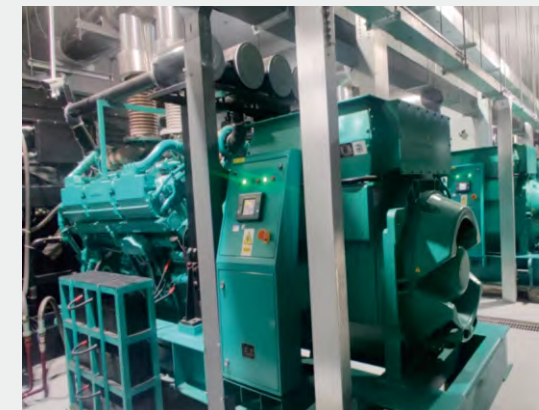
■ Shanghai Qibao Data Center
